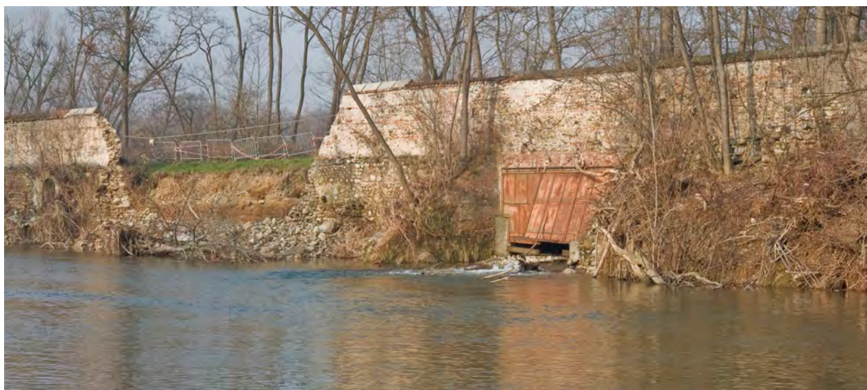
Fig. 6 - In primo piano si nota l'immissione del Valsoglia in sponda sinistra del Ceronda. Tale immissione avviene con passaggio di acqua sotto paratoie metalliche parzialmente arrugginite ed in grado di sollevarsi per assecondare il livello idrico dell'affluente; esse servono per impedire l'uscita degli ungulati. Immediatamente a monte si osserva l'effetto dell'erosione spondale che ha comportato il crollo di un tratto del muro di cinta ora delimitato da una recinzione di sicurezza. Dietro quel muro passa la stradina ciclo-pedonale che reca verso la Bizzarria ( fig. 1 ).
